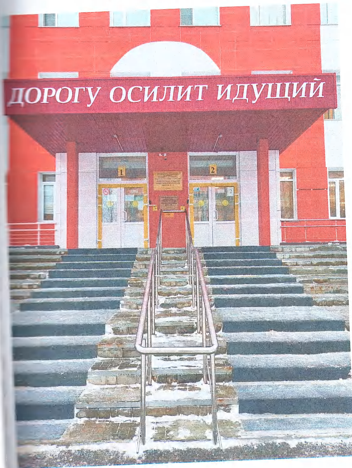
Травмобезопасные поручни на крыльце
